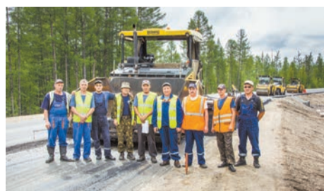
Бригада по укладке асфальта МК-154 имеет большой опыт работы на автодорогах федерального значения.
